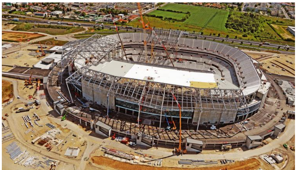
■ Les travaux du futur Grand Stade étaient déjà bien avancés le 12 mai 2015. Photo Richard Mouillaud
